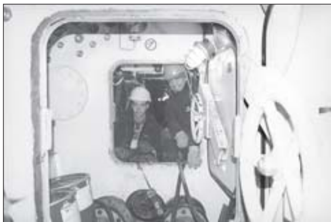
Vstup k uzávěru vzduchové komory uvnitř štítu
