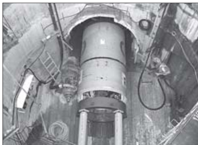
Tlačný rám v šachtě
